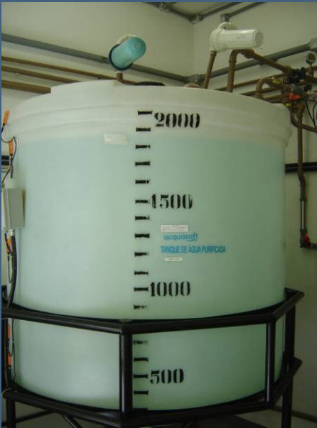
Tanque de Água Tratada Subsistema de Pós- tratamento
