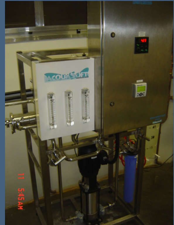
Unidade de Osmose Reversa – Subsistema de Geração
